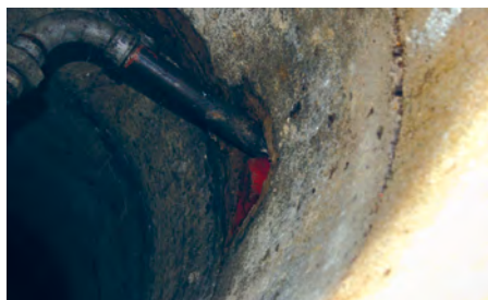
Nicht ausreichend abgedichtete Rohrdurchführung
