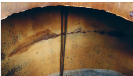
Feuchtigkeitseintritt zwischen Schachtringen
