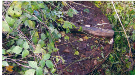
Korrodierte, nicht tagwasserdichte Abdeckung
