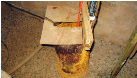
Mangelhafte Abdeckung Brunnenrohr
