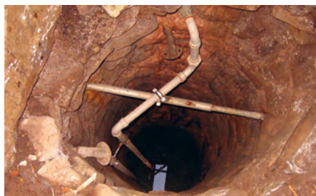
Korrodierte Rohre, starke Eisenoxidausfällungen
